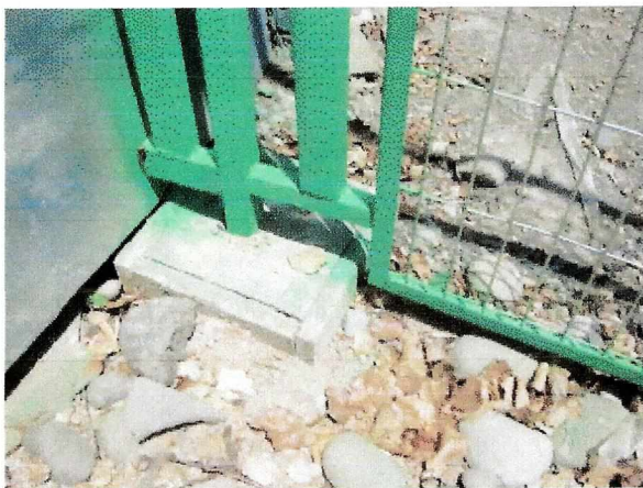
Fotografía N° 48: Vista del desprendimiento de la pintura.
