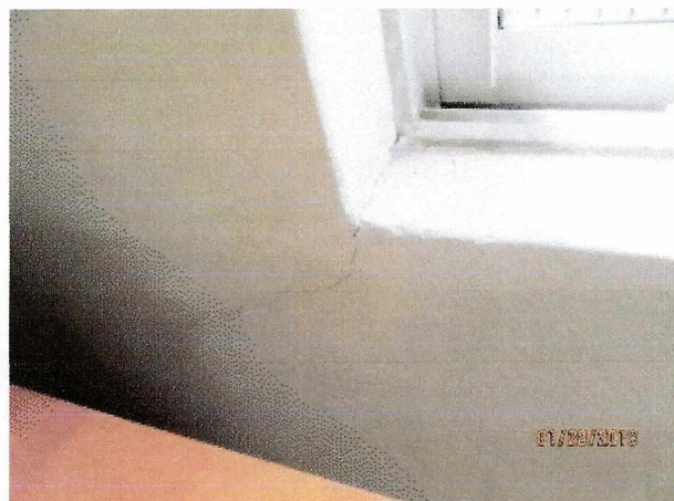
Fotografía N°20: Vista la fisura en la oficina de la sede Doña Eusebia.
