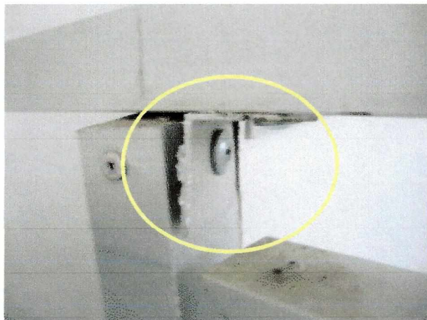
Fotografía N°4: Vista de la escuadra de aluminio mal colocada al perfil vertical.
