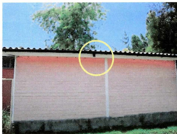
Fotografía N°35: Canaleta con bajada de aguas lluvias faltante.
