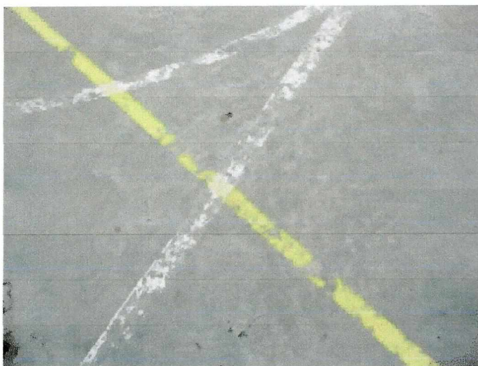
Fotografía N°1: Detalle de la demarcación de la multicancha, con deterioro de la pintura.
