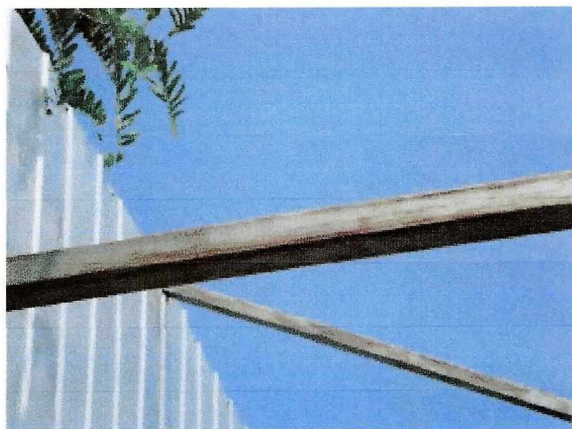
Fotografía N° 49: Perfiles de la planta con presencia de corrosión.
