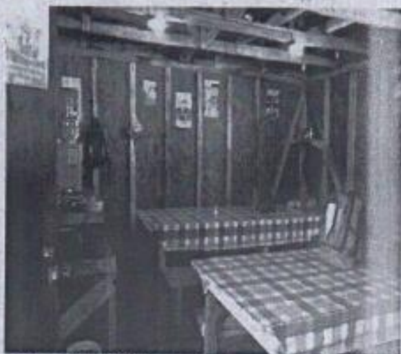
Fotografía N°33, de 2 de agosto de 2016: Asientos en instalación destinada a comedores de los trabajadores desprovista del recubrimiento de un material lavable.
